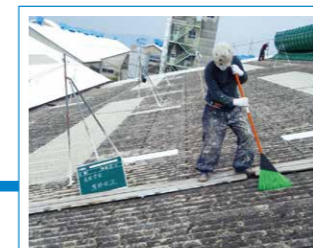
ケレン清掃(真空掃除機) サビ、劣化層、ホコリ、コケ等の除去。
